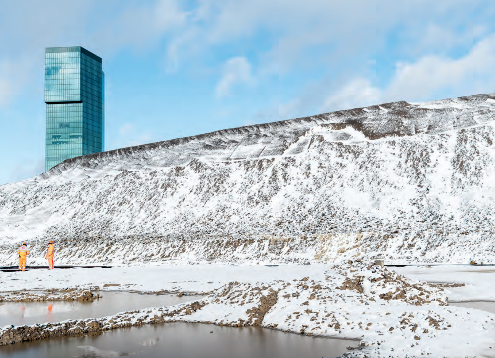
Im Januar 2018 ist am Rand der Baugrube vom PJZ noch nichts zu sehen. Im Hintergrund der Prime Tower.
