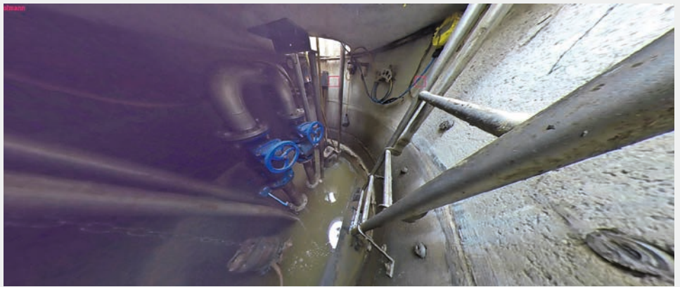
Fig. 4 360°-Bild «über Kopf» durch einen Schacht in ein Pumpwerk.
