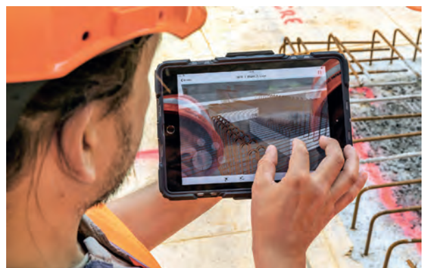
Alle Beteiligten auf der Baustelle arbeiteten ab Modell, so auch der Eisenleger. Er konnte die Bewehrung seinen Bedürfnissen entsprechend anzeigen – im Schnitt, im Grundriss oder in 3D. Jeder Stab war mit Durchmesser, Teilung und Positionsnummer versehen. (Bild: Basler & Hofmann AG, Stefan Kubli)
