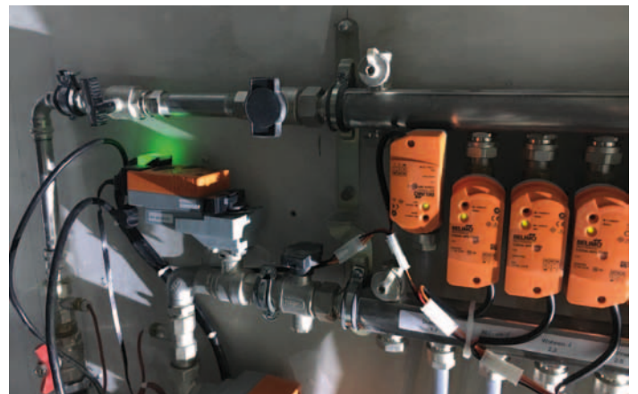
Hinter den Kulissen sorgen die orangenen Belimo Antriebe im intelligentesten Wohngebäude Deutschlands, dem «apartmentum» in Hamburg, für bestes Klima
